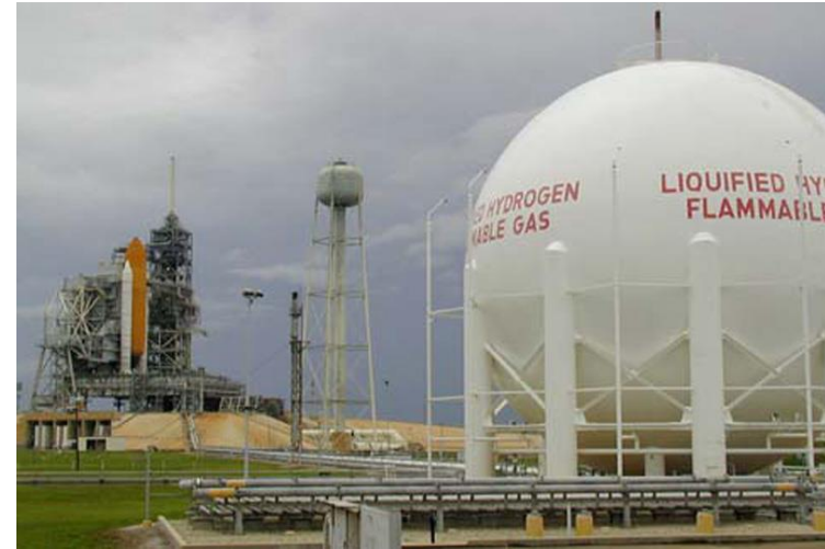
Almacenamiento de hidrógeno
